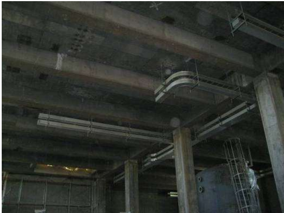
2007年7月27日 ECB Cable Tray 安裝現況相片
