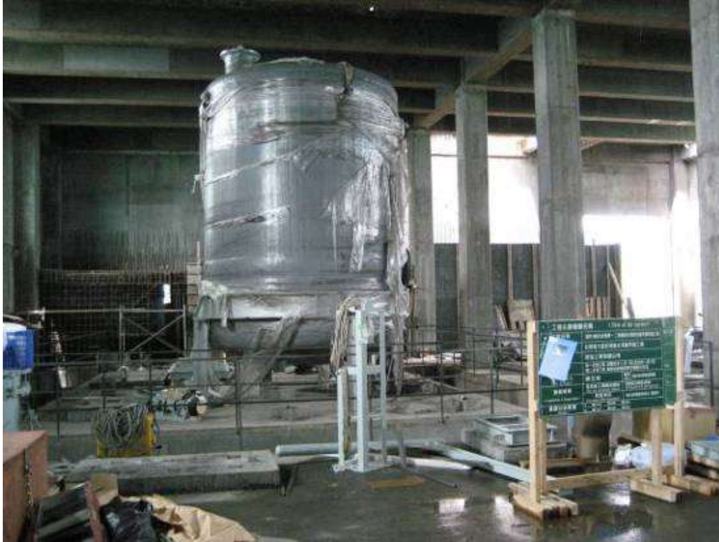
2007年5月22日 ECB 1Y54-TNK-5004 安裝現況相片
