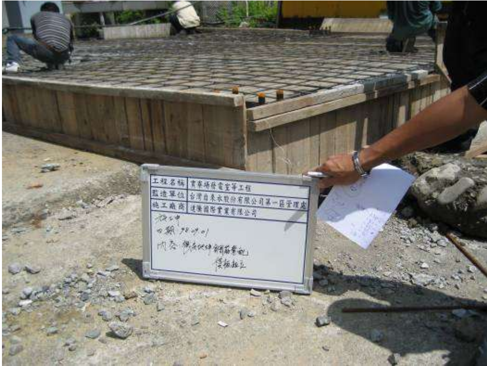
2009/09/01 上午 10:55 貢寮、雙溪營運所(發電機室地坪鋼筋紮配、模板組立)(施工中紀錄片)
