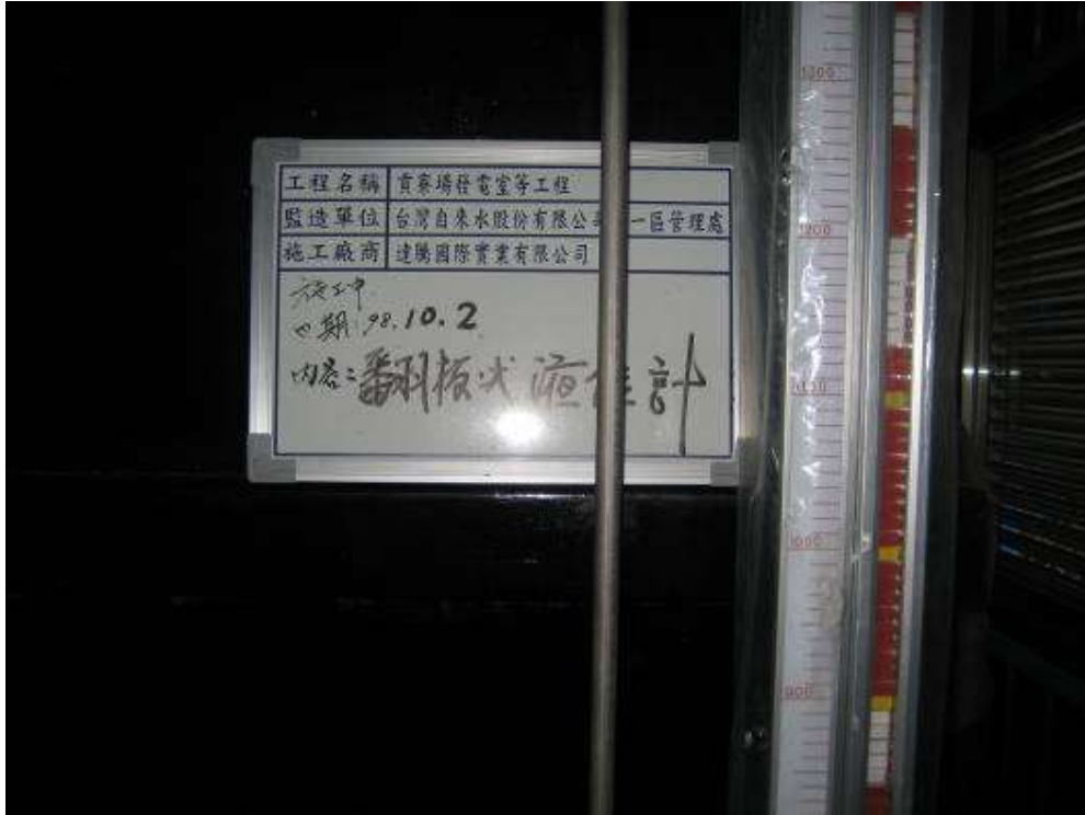
2009年10月2日，下午 02:28 貢寮、雙溪營運所(翻版式液位計施作)(施工中紀錄片)
