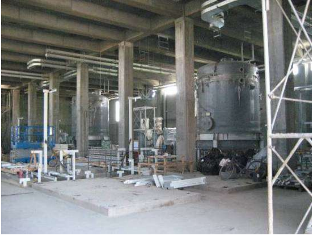
2007年7月21日 ECB 1 / 2Y54-TNK-5004 安裝現況相片
