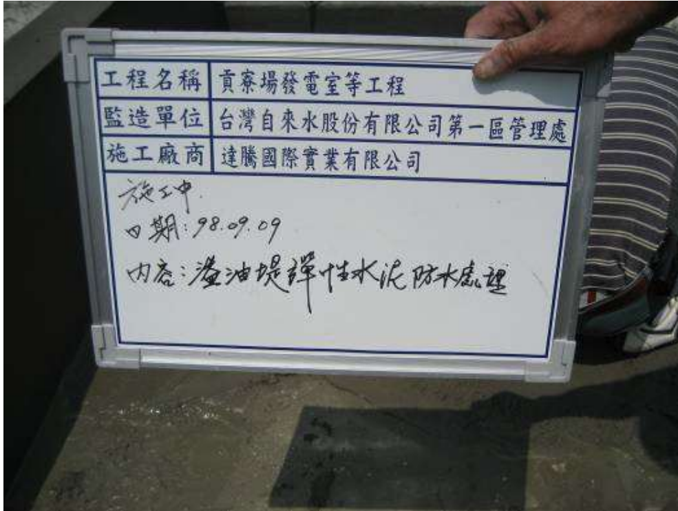
2009/09/09 上午 11:18 貢寮、雙溪營運所(溢油堤彈性水泥防水處理)(施工中紀錄片)
