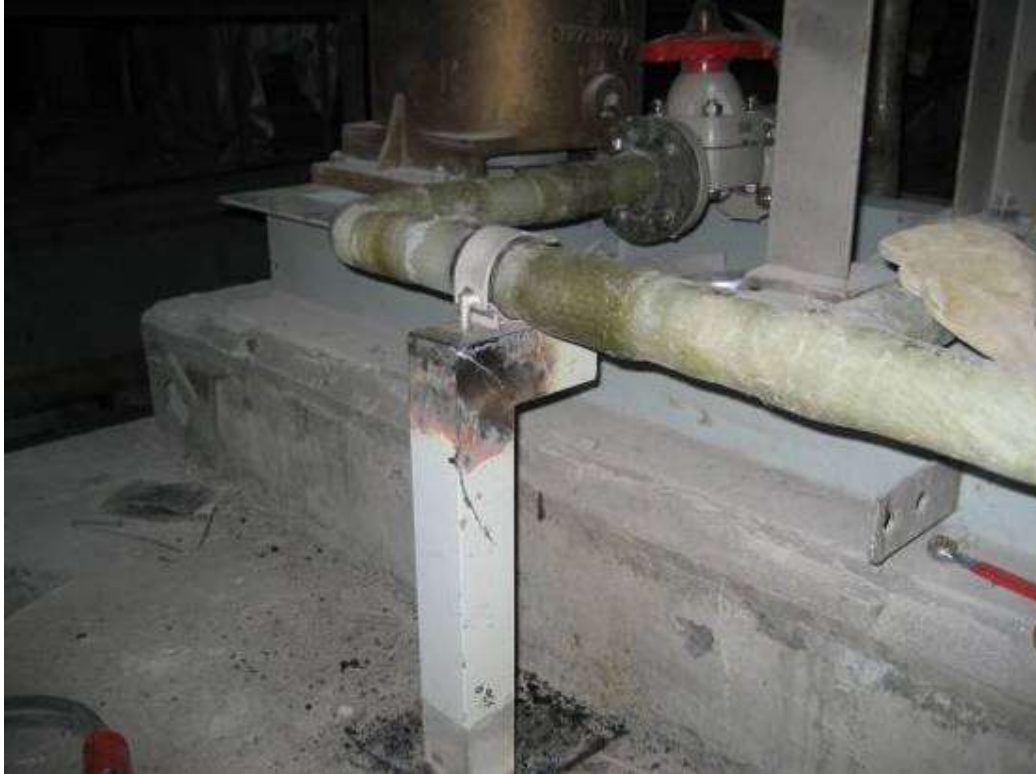
2008年7月13日 ECB Support 與 Pipe 紀錄相片
