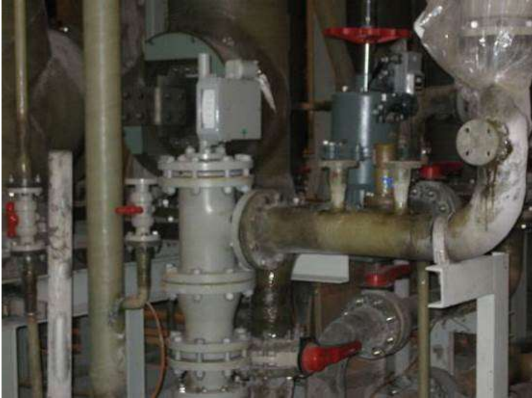
2008年8月5日 ECB Y54 系統面積式流量計安裝完成紀錄相片
