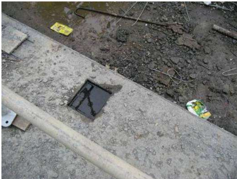
2007年2月14日 ECB現場次氯酸鈉產生器基礎台現況相片
