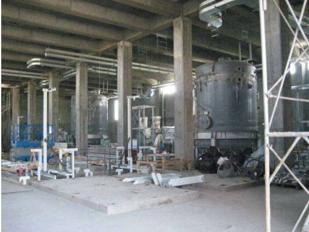
2007年7月21日 ECB 1 / 2Y54-TNK-5004 安裝現況相片
